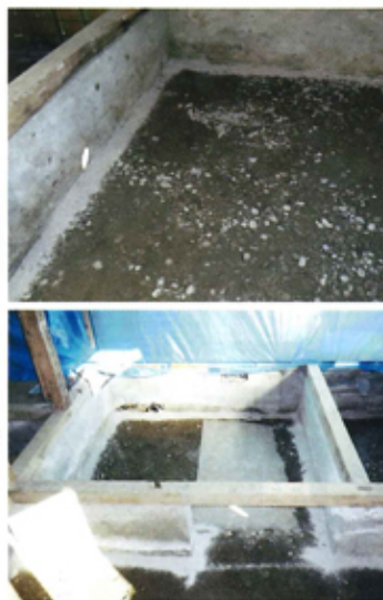
床下整備と配管・改修の様子。[左]床下を徹底調査し被害部を撤去・補修。特殊ホウ酸処理を施す。[右]配管を敷設し蓄熱体となる土間コン施工後、さらにカーボンペイントを塗布し調湿
